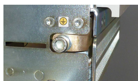
Point de connexion sur base débrochable
